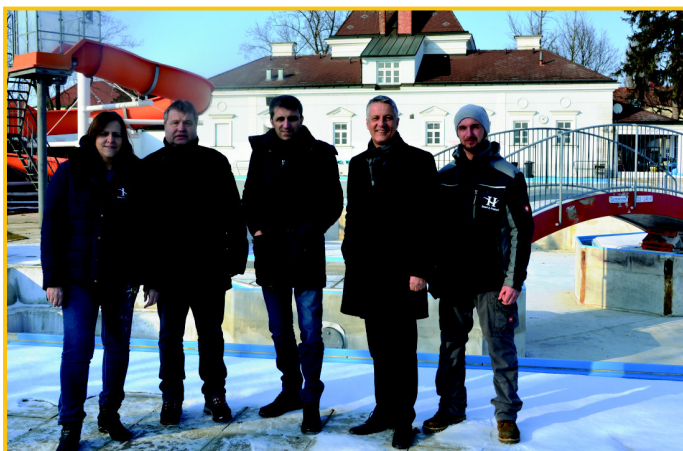
Martina Unhaller Verwaltung, STR Wolfgang Scharinger, Bürgermeister Erwin Bernreiter, Sportbetriebschef Helmut Schneider und Bademeister Johannes Mayer bei der „Baustelle“ Freibad. Die umfangreiche Sanierung der beiden Hauptbecken läuft über die kalte Jahreszeit weiter
